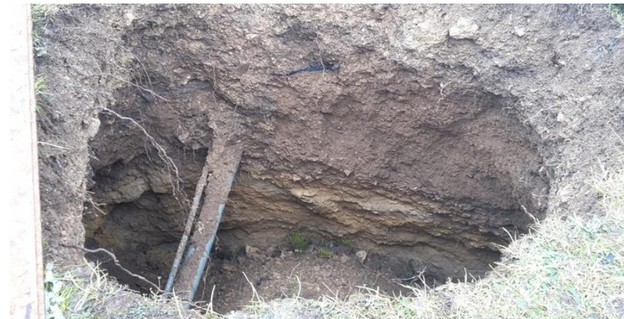
Effondrement rue Landrecourt – Dugny sur Meuse – janvier 2019
